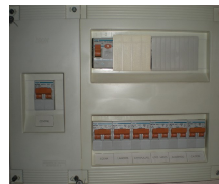
Interruptor de Control de Potencia
