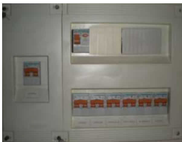
Interruptor de Control de Potencia (ICP)
